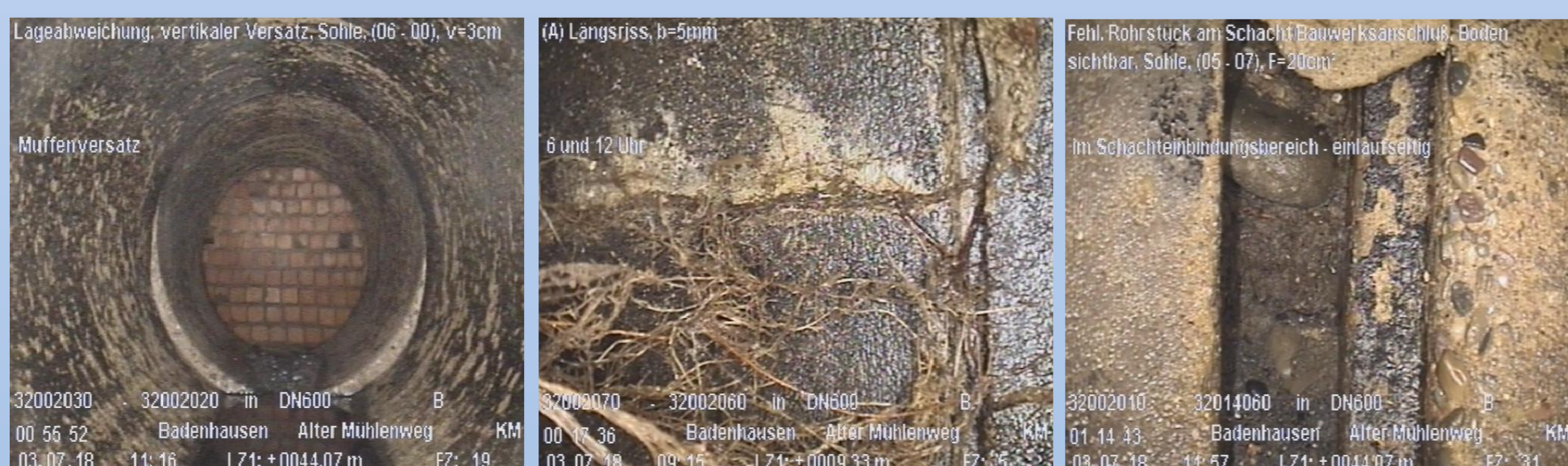
Abb. 1: Darstellung der Schäden des Hauptsammlers im Straßenzug „Alter Mühlenweg“. (Harzer Ingenieure für Umwelttechnik GbR, 2018)
